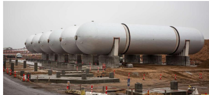
Below Ørsted Kalundborg CO 2 Hub with horizontal tanks (Esben Hjort, Ørsted)
